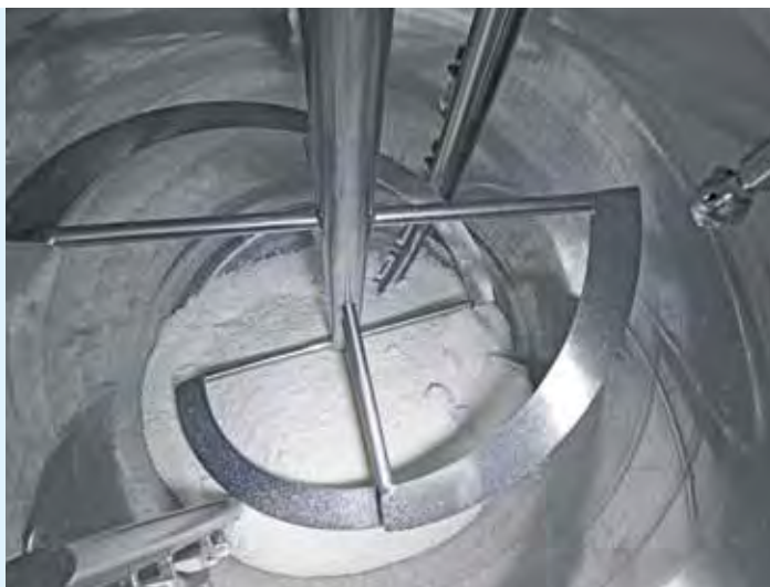
Rührwerk mit Abstreifern im Schmelzbehälter
