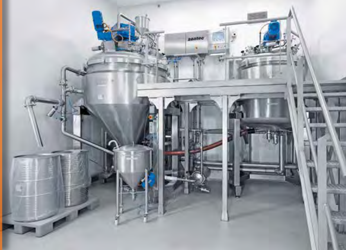
Batch Vakuum-Prozessanlage mit separatem Schmelzbehälter
