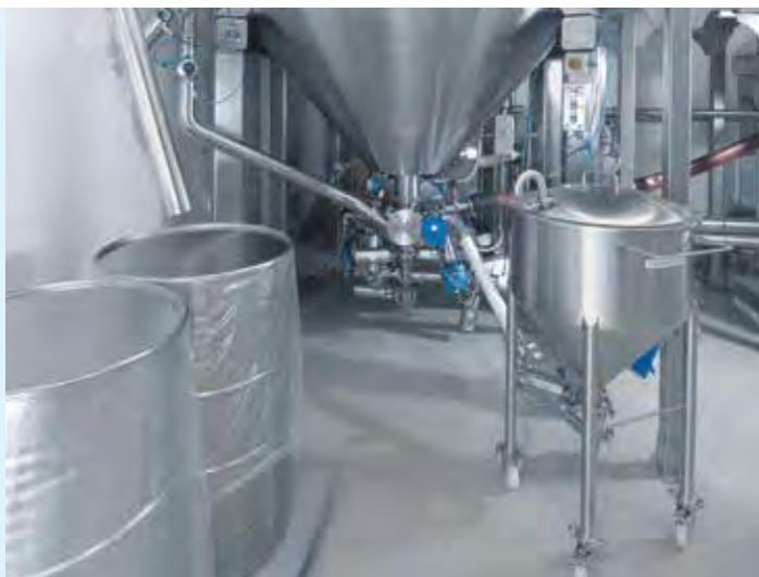
Vorlagebehälter für pulverförmige Rohstoffe
