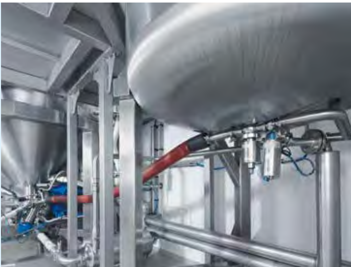
Isolierte Transferleitung vom Schmelzbehälter zum Prozessbehälter
